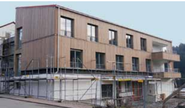
Der Anbau des LZE in Ebhausen ist außen fast fertig und wird innen bereits bezogen. (Foto: Link)
